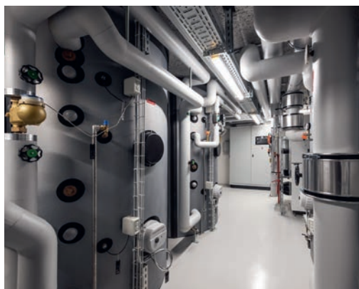
Ein Blick in die Energiezentrale, welche die lokale und saubere Energie steuert.
