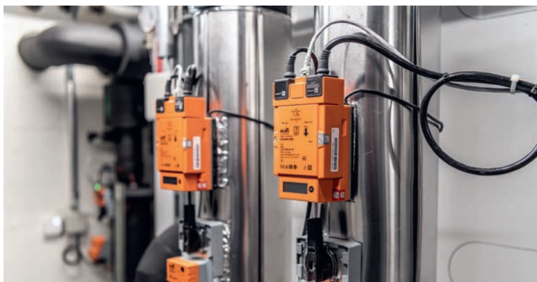
Im ehemaligen Öltank der Siedlung befindet sich nun die topmoderne, neue Energieversorgung mit zwei Wärmepumpen.
